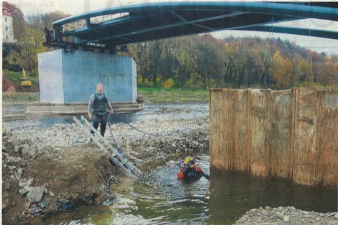
Gerüstet für die nächsten zwei bis drei Stunden: Gerd Wirth von der Wittenberger Spezialfirma steigt an der Spundwand der Brückenbaustelle unter Wasser, um hier die Brennarbeiten auszuführen. Michael Scheide gibt am Ufer Unterstützung. Foto: Silke Hoffmann
