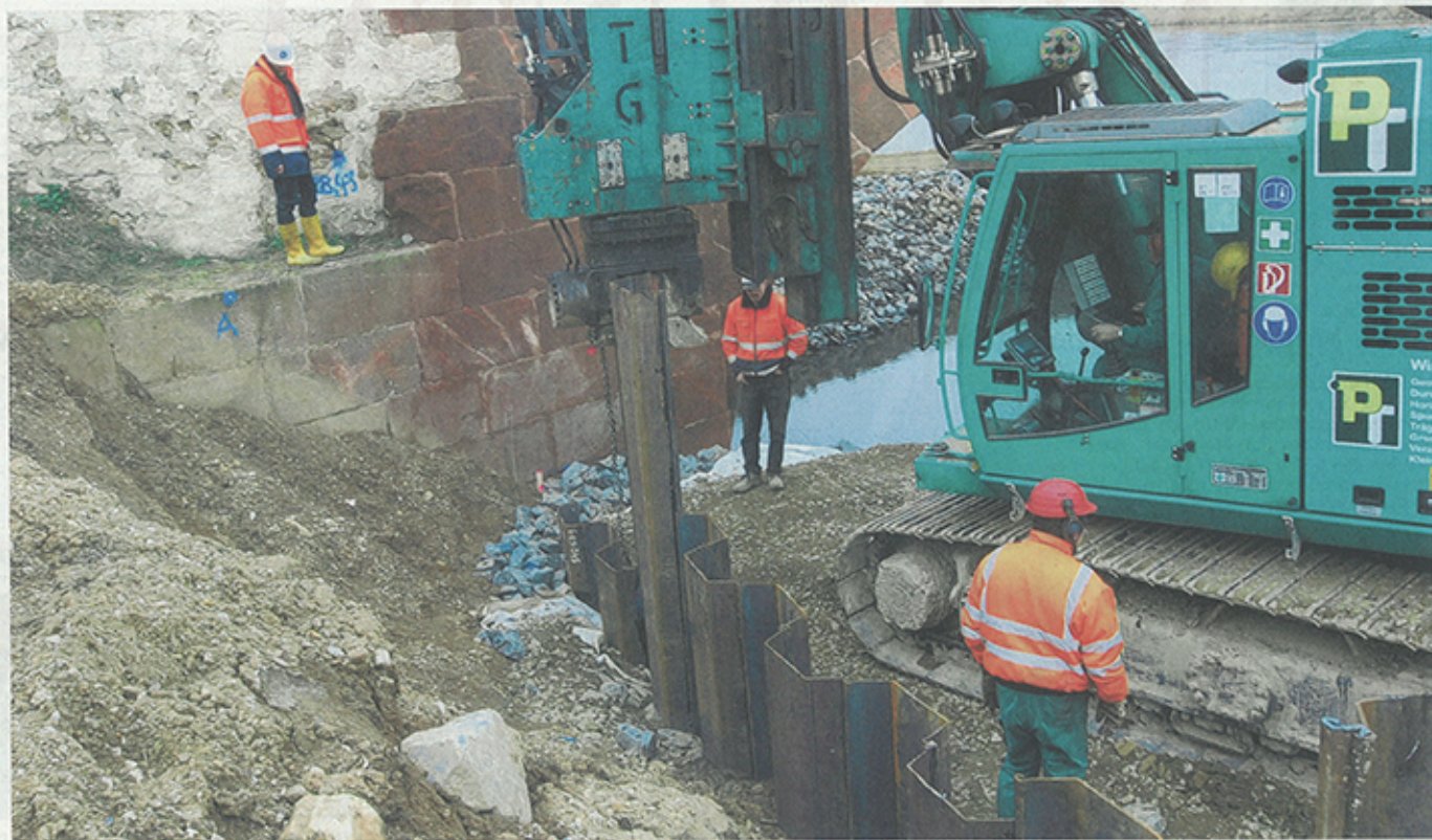
Brückenbau geht in die nächste Runde: Aus Stahlsegmenten wird ein Kasten gebaut, mit dem die stadtseitigen Pfeiler trocken gelegt werden. Darin kann später an den Pfeilern gearbeitet werden. Foto: Ralf Zweynert
