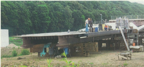
Vorbereitung für die Montage im September: An der ersten Hälfte der neuen Brückenkonstruktion aus Stahl wird emsig gehämmert und geschweißt.
