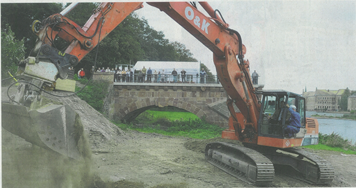
Symbolischer Baggerhub: Assistent von Baggerführer Ronny Behrendt schaufelt Grimmas Oberbürgermeister Matthias Berger eine Ladung Erde auf dem Muldeufer beiseite. Damit begann gestern offiziell der Wiederaufbau der Pöppelmannbrücke. Foto: Andreas Röse
